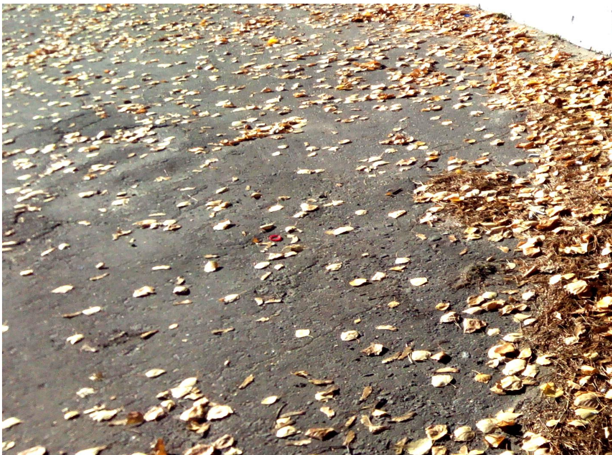
Фото, отражающие состояние асфальтобетонного покрытия
