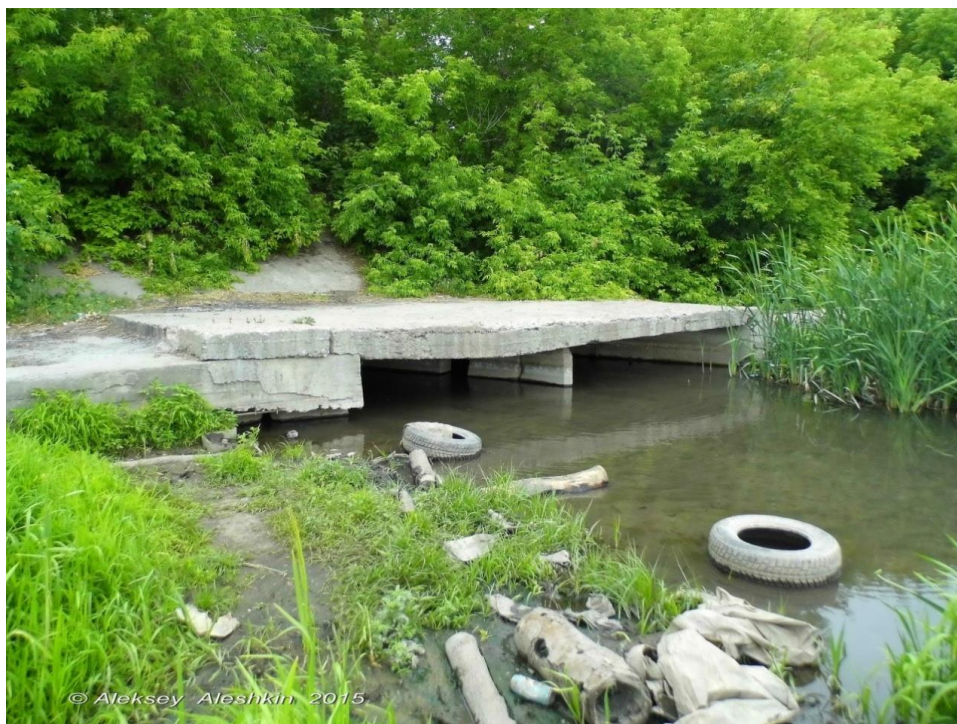
Фото 5. Река Мойка внешнее состояние
